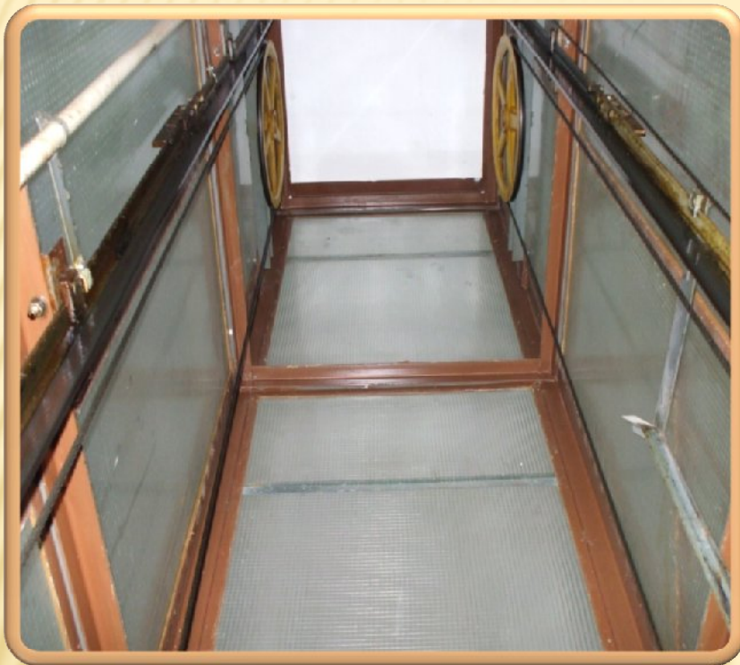
so strojovňou dole prevádzacie kladky v hlave šachty
