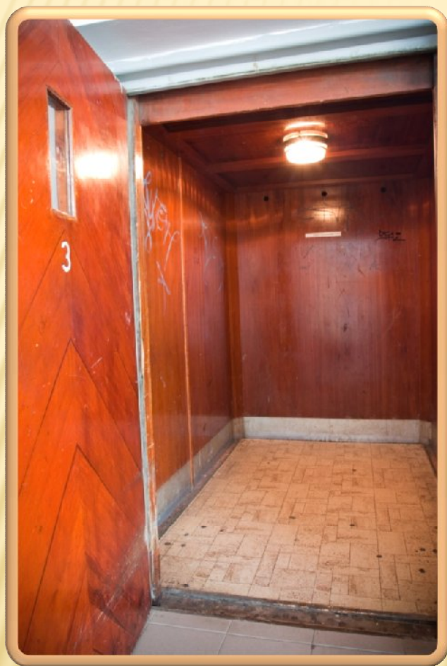
stará kabína bez kabínových dverí a staré ručné drevené šachtové dvere
