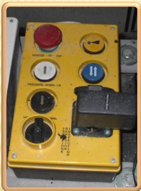
skrinka revíznej jazdy na kabíne
